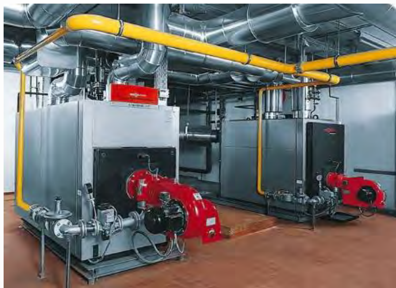
Водогрейный котел и газопроводы
